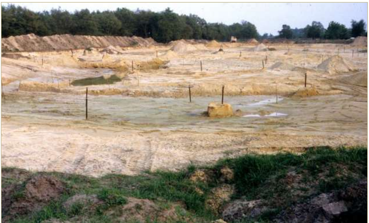
Een maand later vanaf vrijwel hetzelfde punt. Van onder het zand komt blauwgrijze keileem tevoorschijn en de eerste plas vult zich met grondwater. Op de palen in het terrein is aangegeven hoe diep er moet worden gegraven (juni 1991).
